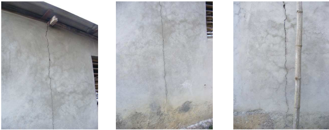
a) b) c) Figura 11. a – c. Ampliación de grietas existentes, haciéndose pasantes.
