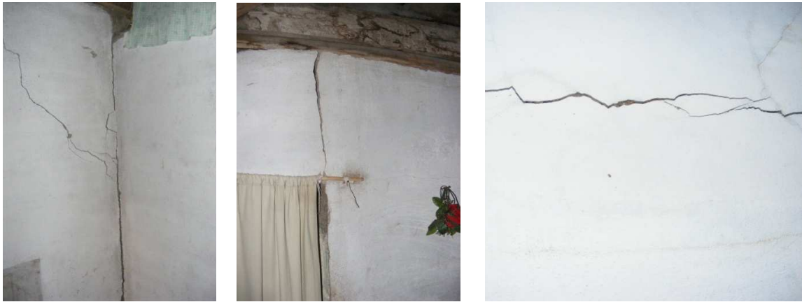
c) d) e) Figura 10. a – c. Fisuras y grietas en varias direcciones, en muros de mampostería simple.
